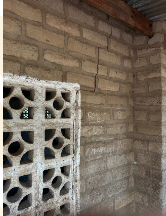
Beschädigung der tragenden Bausubstanz
